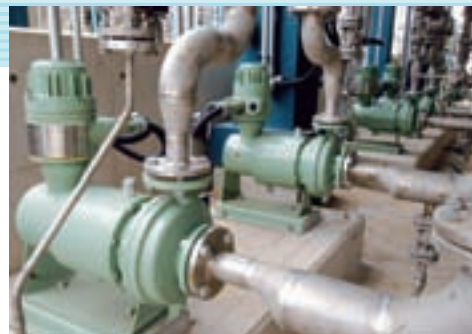
工場に設置されたノンシールポンプ
