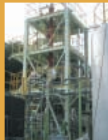
廃水処理プラント
