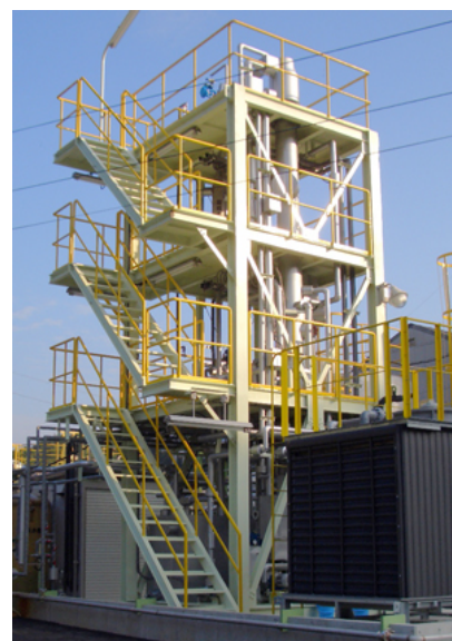
排水処理プラント
